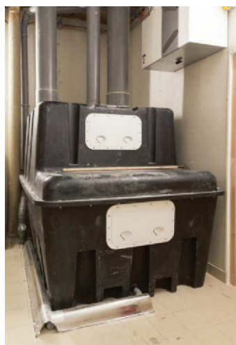
Photo du composteur au rez-de-chaussée
