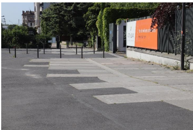
Photo 8 : Discontinuité des revêtements au sol
